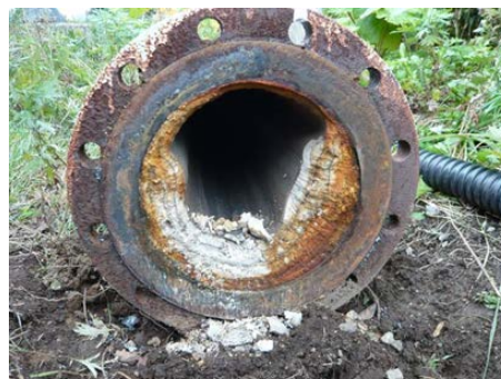
図1 地熱発電所で発生するスケール
