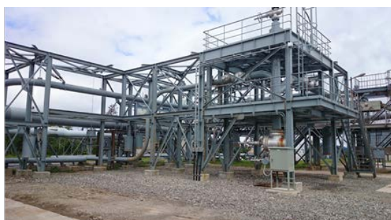
図4 澄川地熱発電所，C基地，SC-4抗の外観
