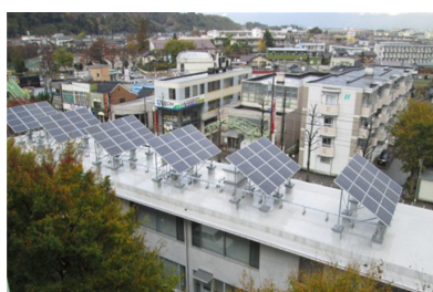
災害対策プラザ太陽光発電
