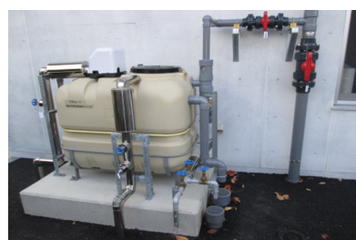
災害対策プラザ雨水利用タンク
