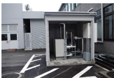
共同利用棟地下水源ヒートポンプエアコン
