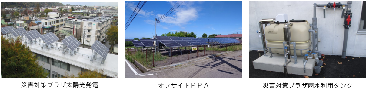
災害対策プラザ太陽光発電
