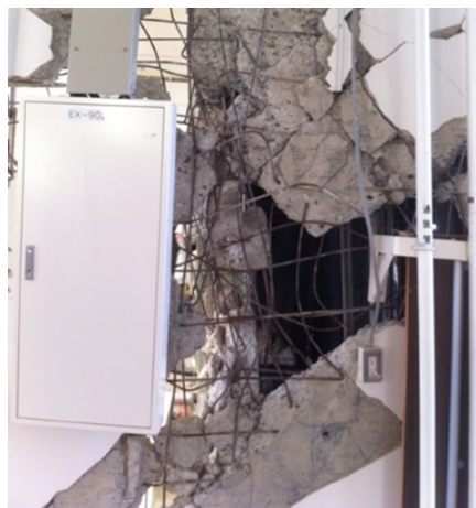
東北大学における被害建物の様子
