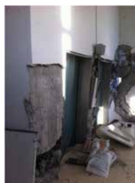
東北大学における被害建物の様子
