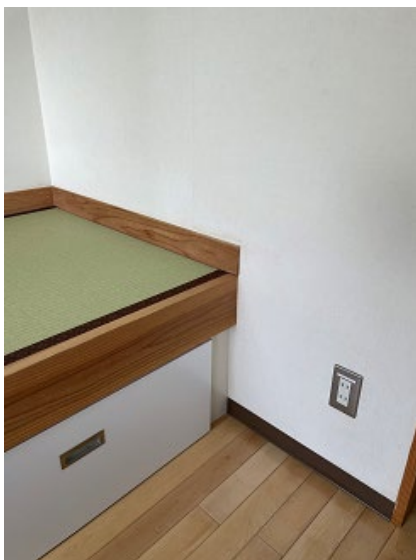
ベッド横のコンセント
