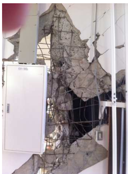
東北大学における被害建物の様子
