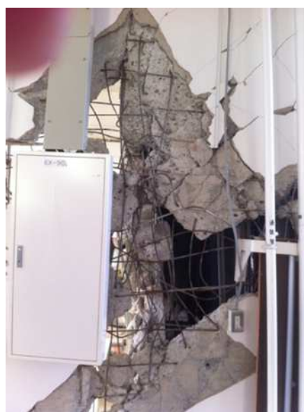
東北大学における被害建物の様子
