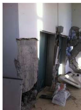
東北大学における被害建物の様子
