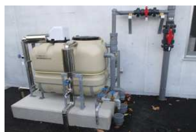
災害対策プラザ雨水利用タンク
