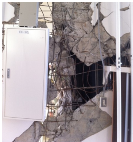
東北大学における被害建物の様子
