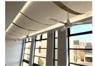
天井送風機（シーリングファン）
