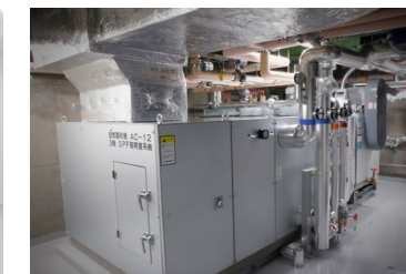
3階空調機械室
