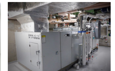
3階空調機械室
