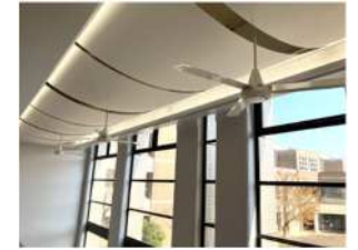
天井送風機 (シーリングファン)
